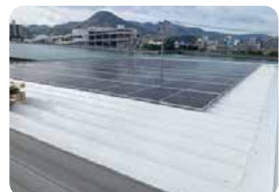
店舗共配センターの太陽光パネル
